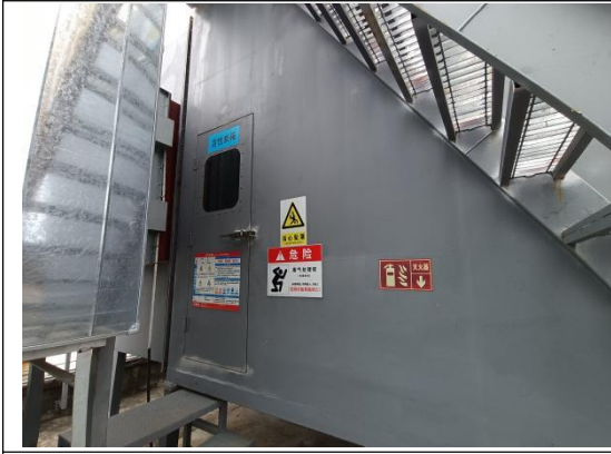
项目废气处理设施活性炭箱
