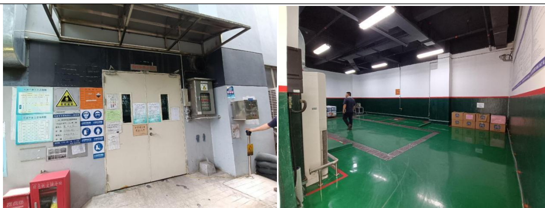
项目危险废物贮存场所标识
