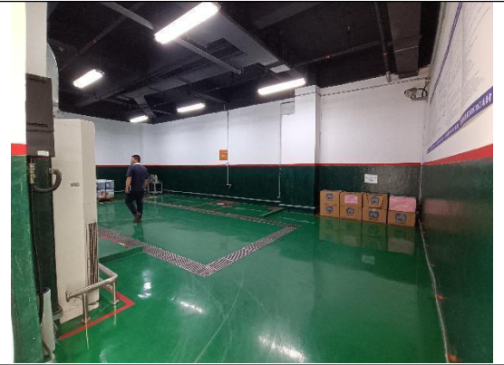
项目危险废物仓库
