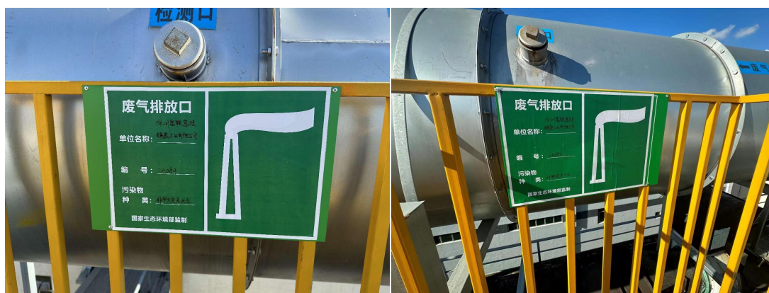
项目废气排放口标识
