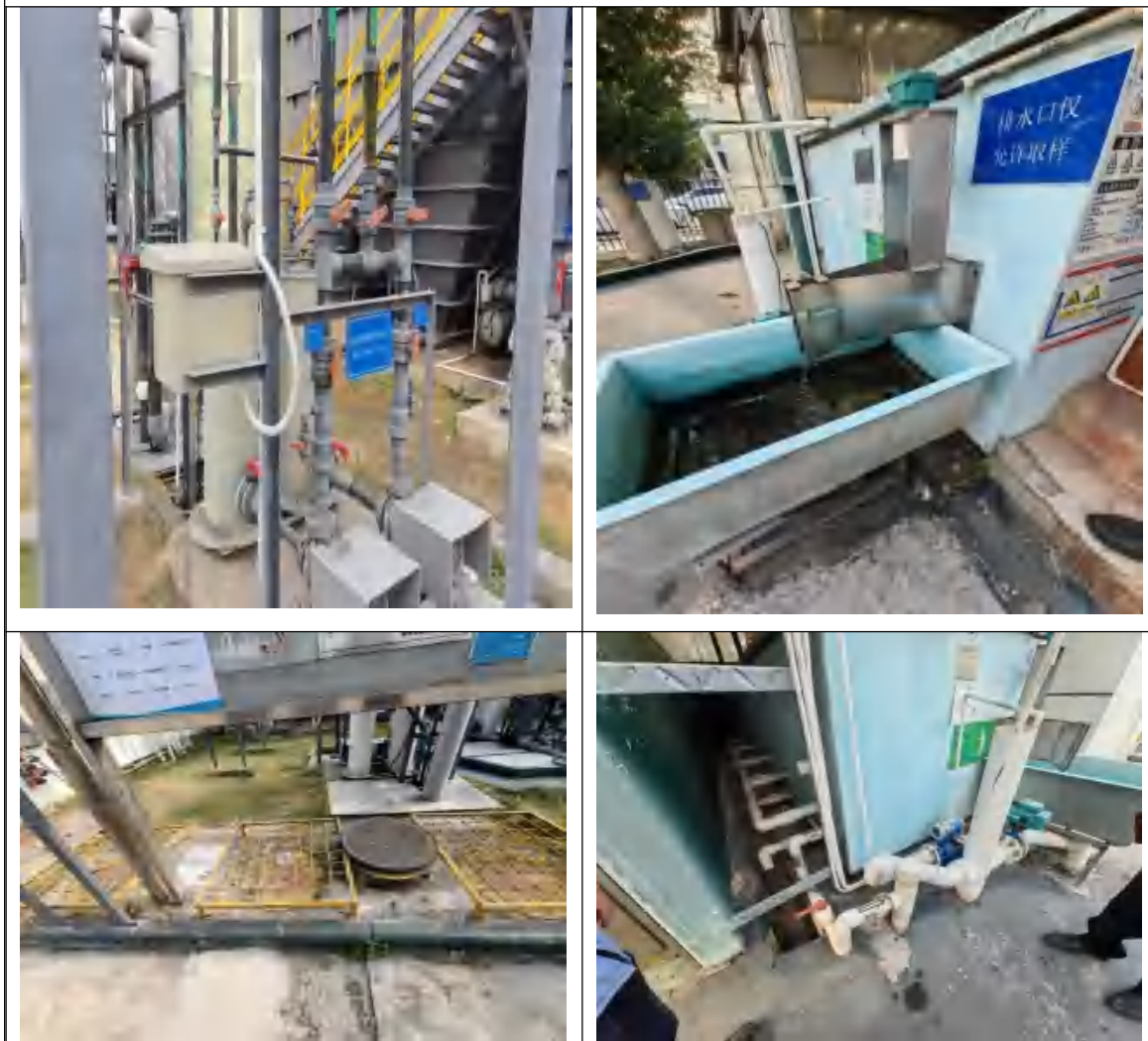
图 3-5 综合废水处理设施图片
