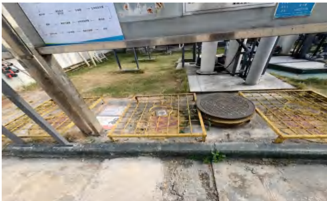
综合废水站地下密闭式集气装置
