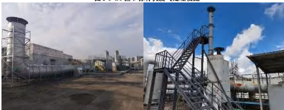
图 3-6 K1 区 13 栋有机废气处理设施、G6 区 5 栋有机颗粒物处理设施
