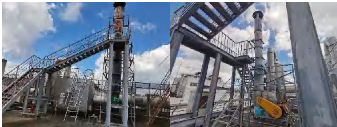
图 3-5 G6 区 5 栋有机废气处理设施
